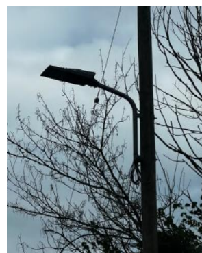
Console sur poteau en bois
